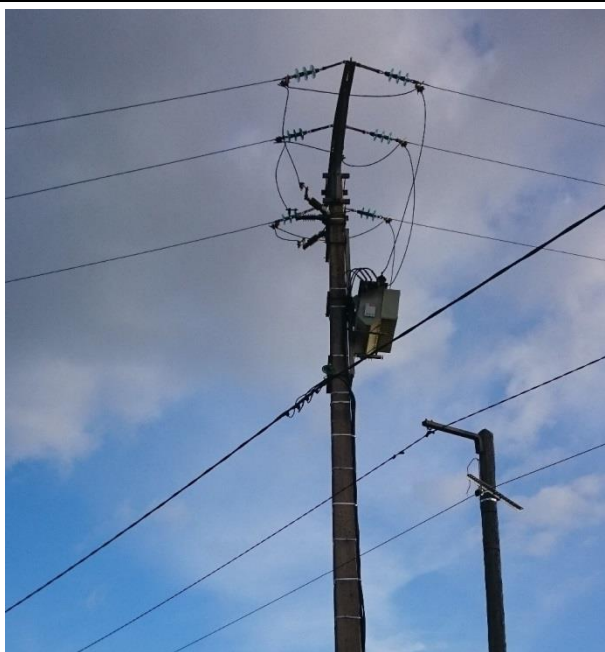
Réseau aérien BT torsadé sur support HTA
