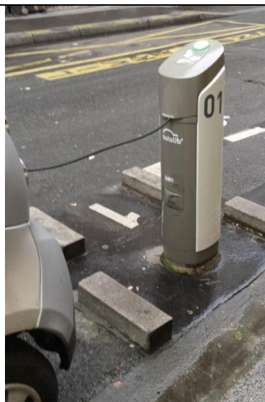
Borne de recharge électrique
